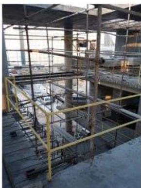
پروژه پارک فناوری پردیس تکمیل عملیات سوراختاری و کاشت آرماتور اکستندهای ووید میانی
