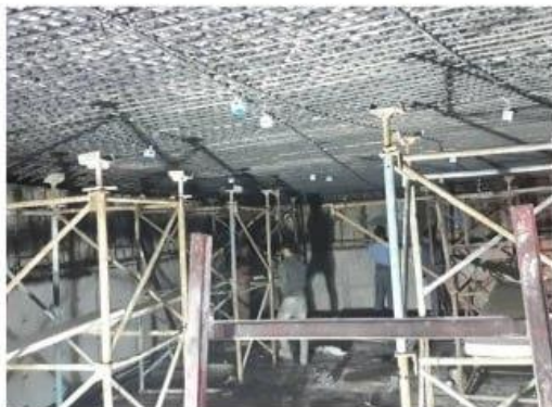
پایان آرماتوربندی، قالب بندی دیوار و انجام عملیات آماده سازی برای قالب بندی زیر سقف به صورت معکوس
